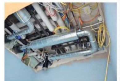
Der KSU-Neubau ist ein komplexes Bauwerk: Noch sieht man die Vielzahl an Leitungen und Kabel, weil die Decke noch nicht montiert ist.
