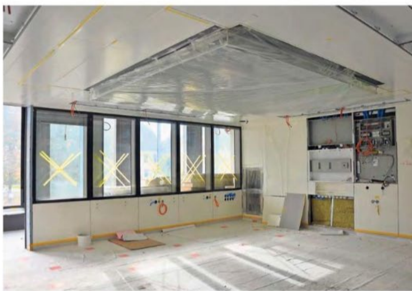
Hier wird künftig operiert: Das neue Kantonsspital wird über drei Operationssäle verfügen, die dem neuesten Stand der Technik entsprechen.
