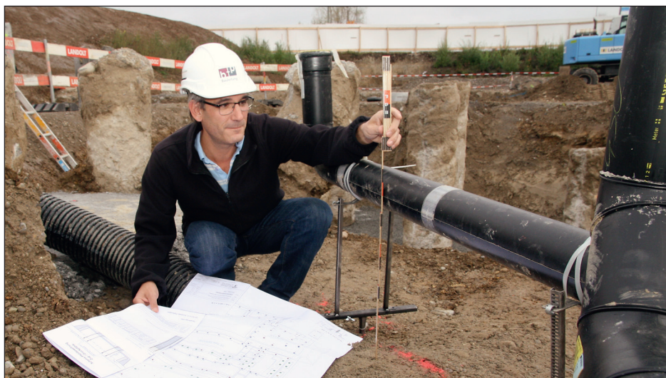
Noch ohne Schnee: Baustellenleiter Beat Eugster kontrollierte im November die verlegten Kanalisationsrohre.
