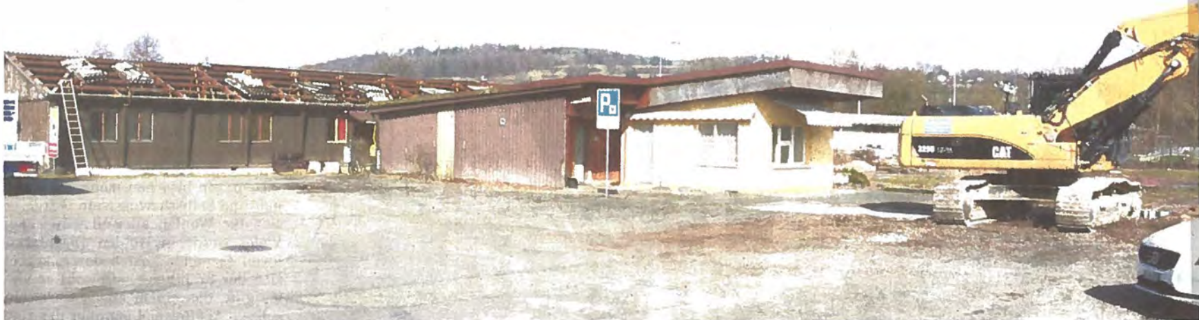
Erste Abbrucharbeiten wurden bei der Asylbaracke (links) gestern Montag in Angriff genommen. Danach wird die Minigolfanlage (Mitte) abgerissen.
