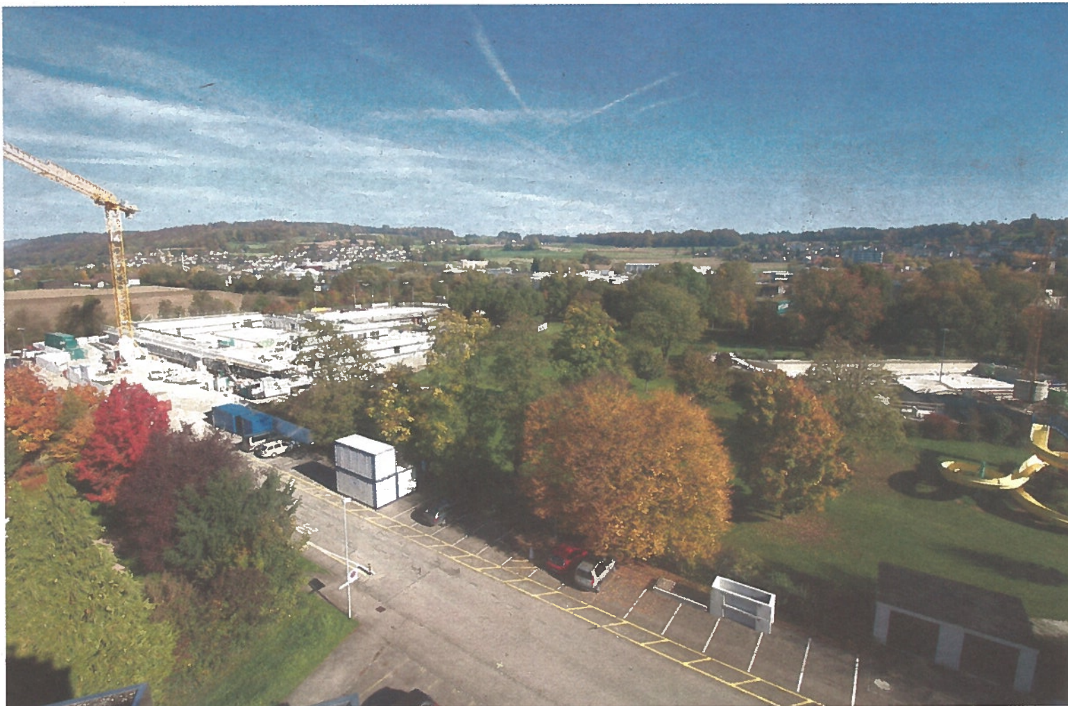
Das vermutlich grösste Bauprojekt der Gemeindegeschichte nimmt Formen an – derzeit wird parallel an Eishalle und Badi gebaut.
