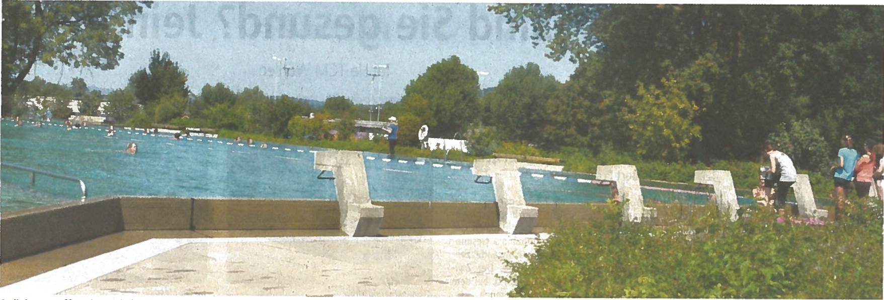
Beliebter Treffpunkt auch für Schulklassen: Die Badi Wohlen ist noch rund eine Woche geöffnet, dann erfolgt der Baustart zu Erneuerung und Sanierung.
