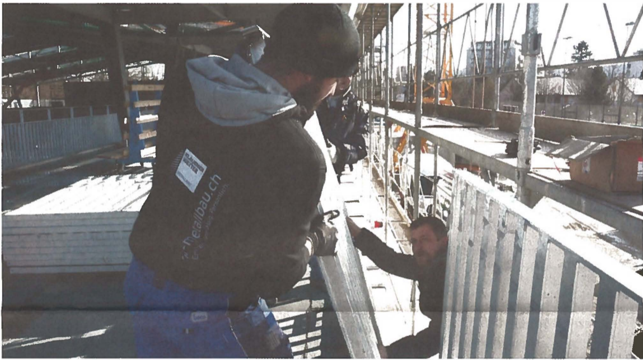
Sicherheit geht vor: Auf der begehbaren Dachfläche rund um die neue Eisbahn werden noch vor dem Tag der offenen Tür die Randgitter montiert. Damit auch wirklich niemand runterfällt.
