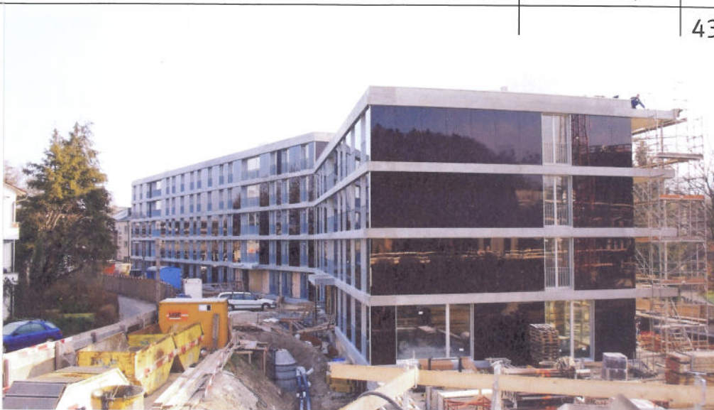
Bei der 2007 fertiggestellten Siedlung Brunnenhof der Stiftung Wohnungen für kinderreiche Familien (Gigon/Guyer) war B & P für die Ausführung verantwortlich (vgl. wohnen 11/07). Trotz klarer Kostenvorgabe konnten attraktive Glasfassaden verwirklicht werden. Heute wäre dies zum gleichen Preis nicht mehr möglich.
